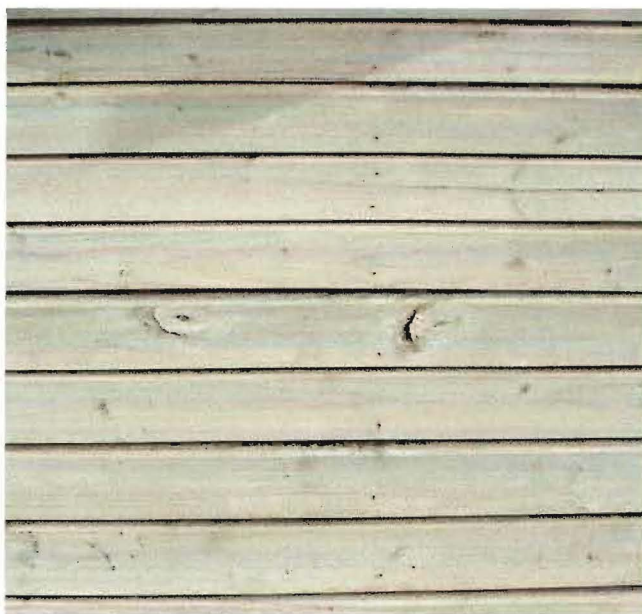
Figura 3.1. Apóstoles. Pared Este de vivienda sin repintar
