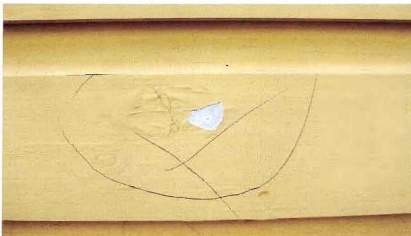
Figura 4.33. Desprendimiento de pintura sobre un nudo
