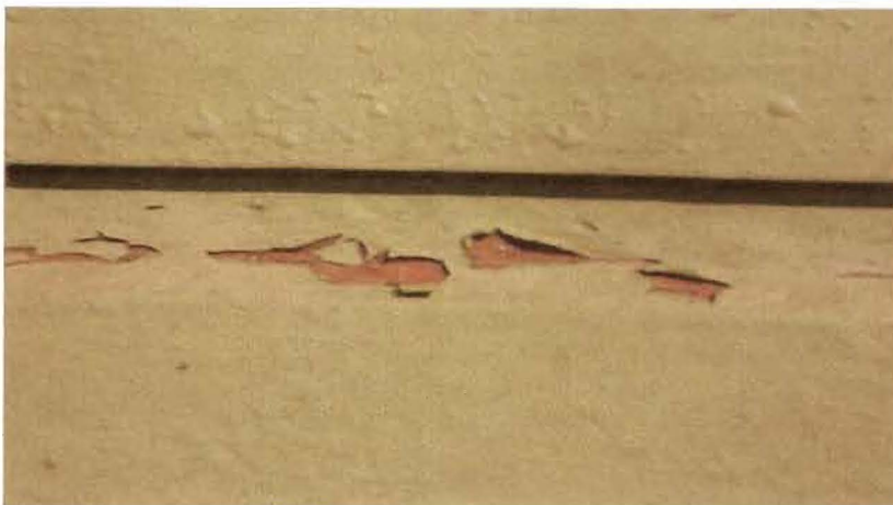
Figura 4.30. Pared este. Pintura que se desprende cuando es calentada por el sol
