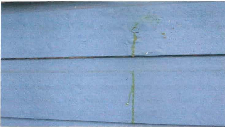
Figura 4.31. Pared oeste. Pintura ampollada por la resina que emerge de la madera
