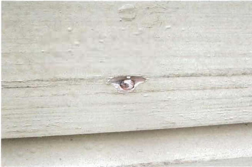
Figura 4.32. Cabeza de un clavo al descubierto por el desprendimiento de la masilla
