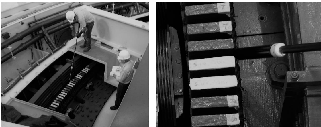
Figura N°1: Medición de DP en cabezas de bobina.
