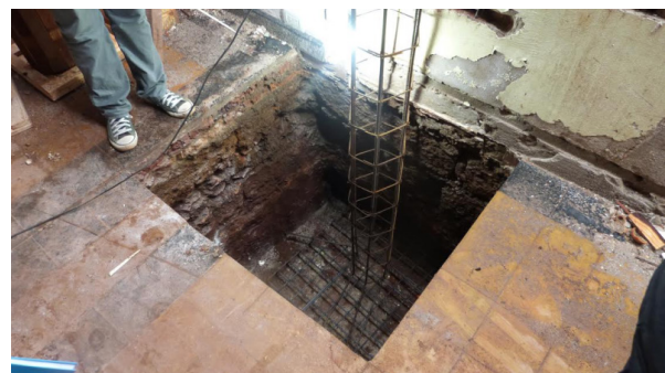
Figura 6. Excavación de la obra en construcción donde se observan las paredes hechas con piedra itacurú del antiguo cotiguazú .
