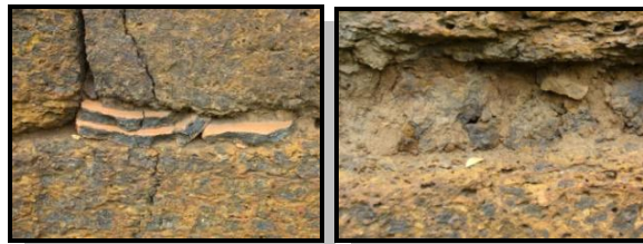
Junta de asiento entre los sillares compuestos por materiales heterogéneos
