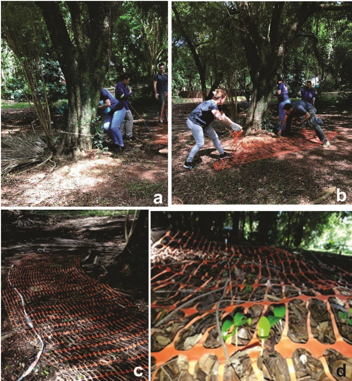
Figura 5. Malla de estabilización. a. Conformación de la capa de mantillo. b y c. Disposición y anclaje de la malla. d. En el transcurso del tiempo se observa el surgimiento de vegetación debajo de la malla.
