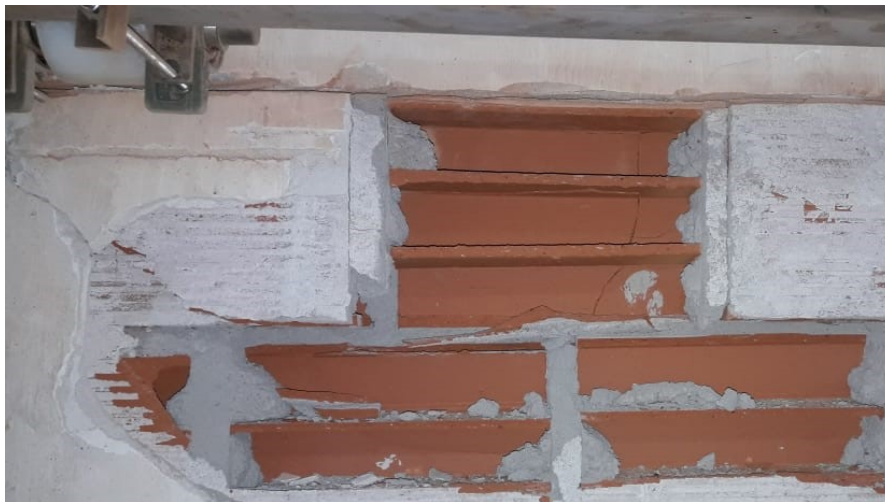
Figura 7.27. Fallas locales por tracción diagonal por corte y desprendimiento del Panel 3.
