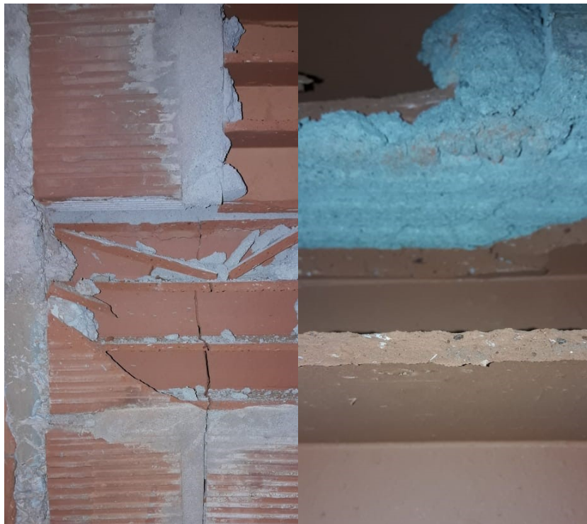
Figura 7.24. Fallas locales en Ensayo CCBF: patrones de fisuras por asentamiento diferencial y desprendimientos por Flexo tracción.
