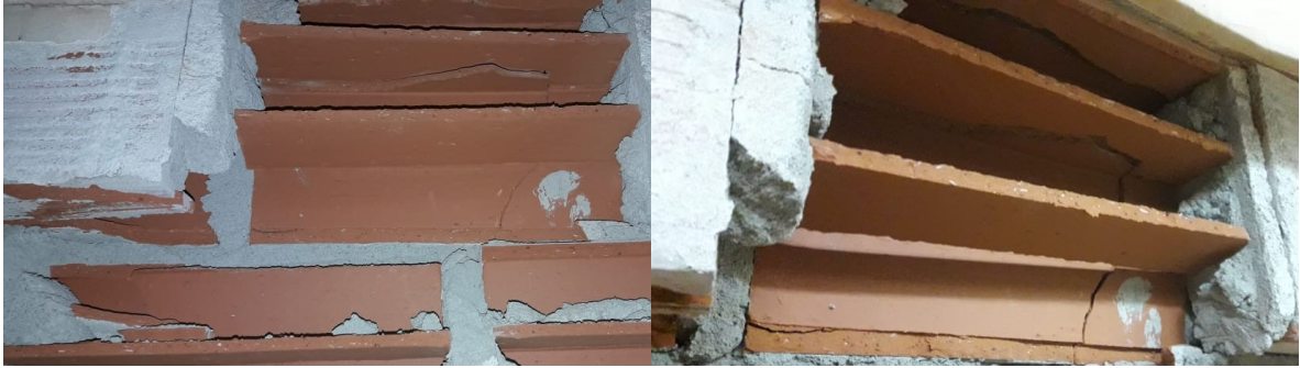
Figura 7.28. Fallas internas y desprendimiento del Panel 3.
