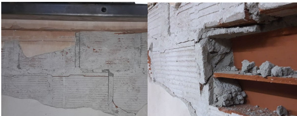
Figura 7.26. Fallas locales atravesando la sección transversal del Panel 3.
