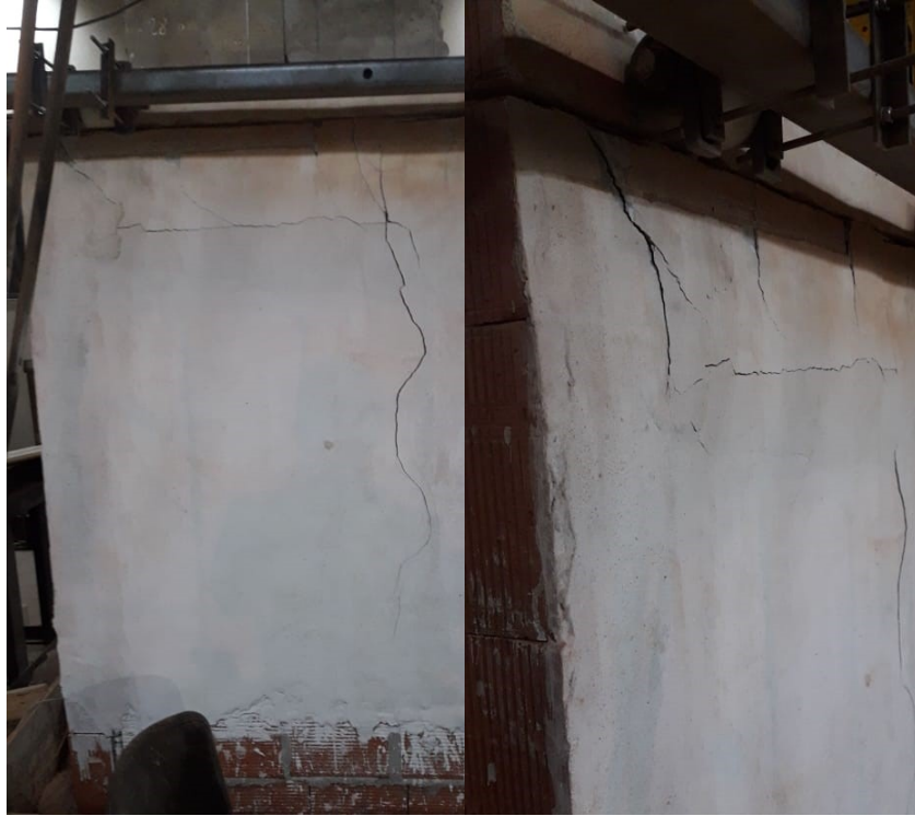
Figura 7.23. Fallas locales en Ensayo CCBF: fisuras por asentamiento diferencial.
