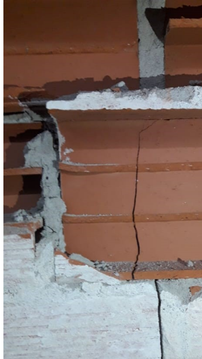
Figura 7.30. Trayectoria de patrones de fisuración de un material a otro.
