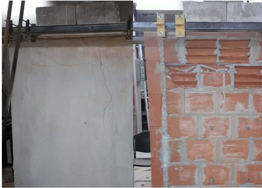
Figura 7.25. Fallas locales en Ensayo CCBF: fallas en lados opuestos del mismo panel.
