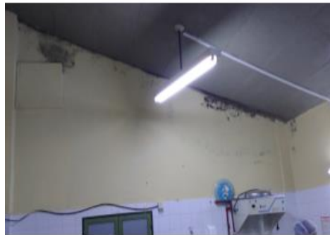
Paredes con abundantes Mohos (08/06/2017)
