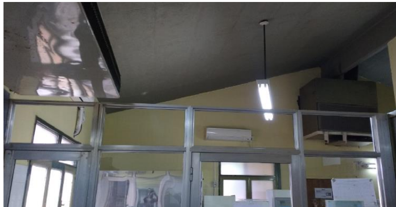
Fotografía 12: Incompleta separación entre áreas
