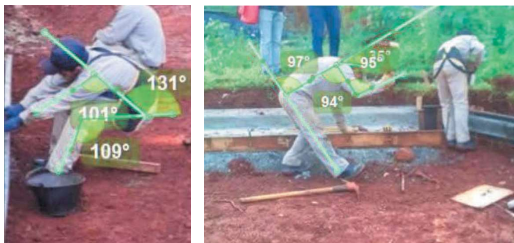
Figura 2- Operarios 2 y 3 en la posición de análisis y ángulos identificados para aplicar el método REBA. Actividad de colocación de moldes metálicos.
