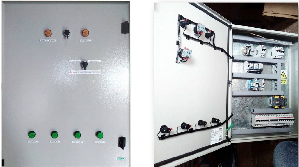
Fig. 5. Tablero eléctrico terminado (Izquierda: Vista Exterior; Derecha: Vista interior)
