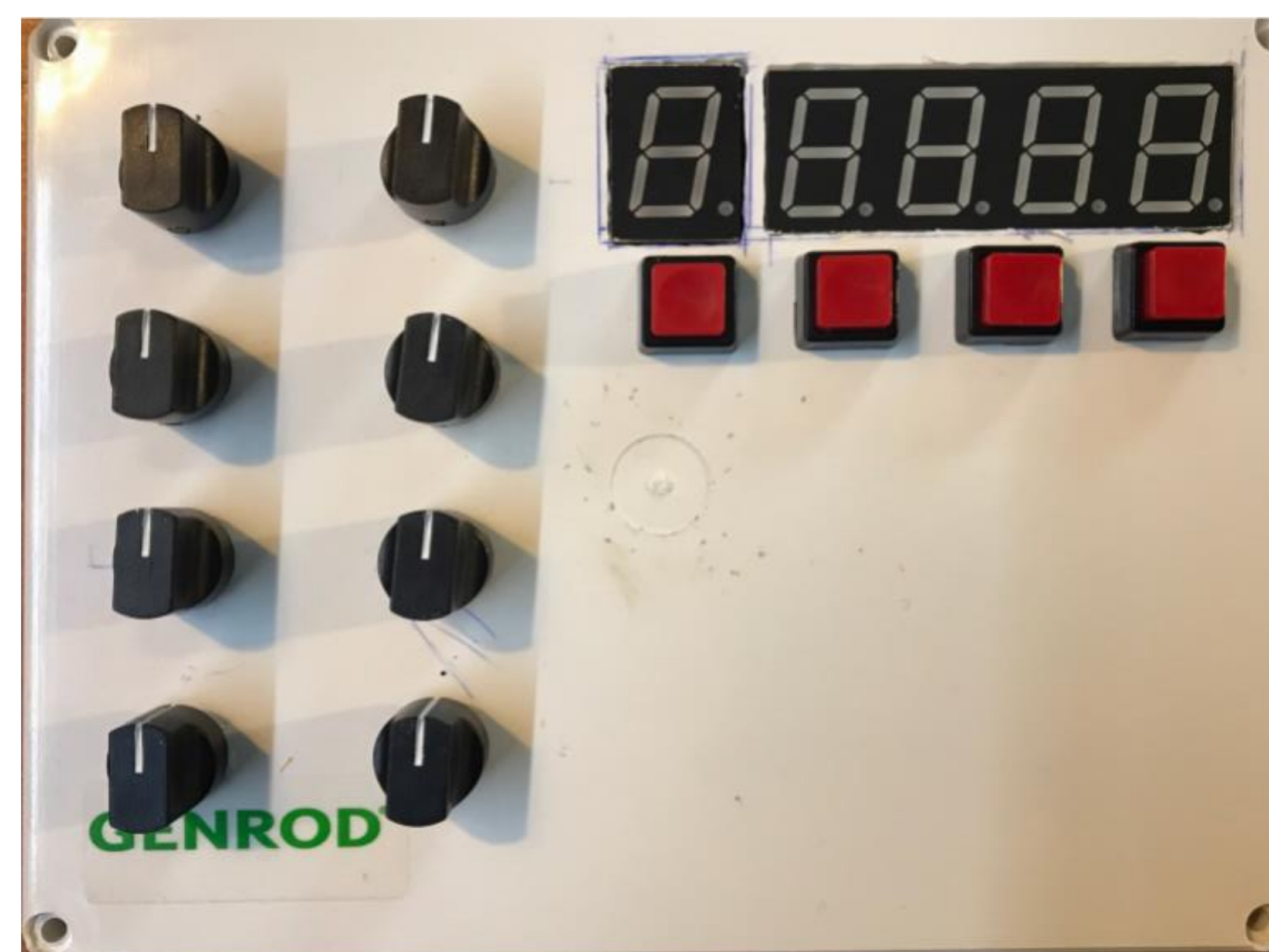
Sistema de automatismo.
